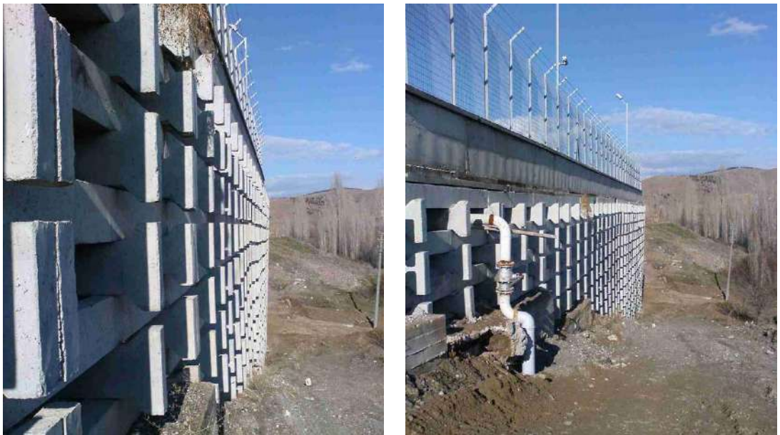
Şekil 2. Dönme ve Oturmaya Maruz Mevcut Duvar Görüntüsü
